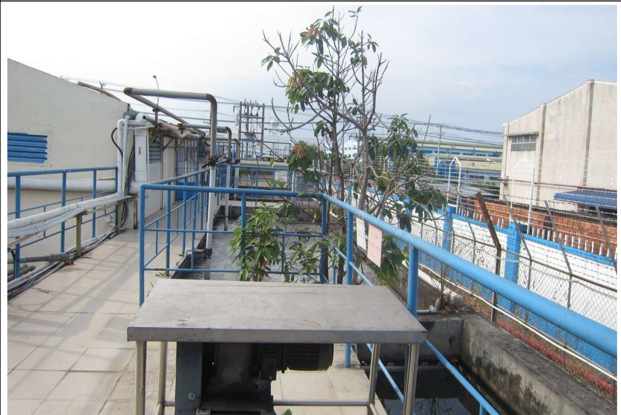
Hình 15: Hình ảnh HTXLNT hiện tại
